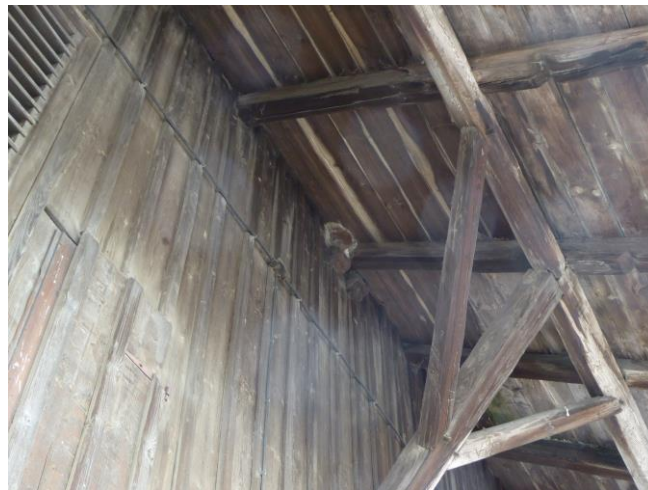
Foto 1 : Abdruck eines ehemaligen Mehlschalbennestes auf der Ostseite des Gebäudes
